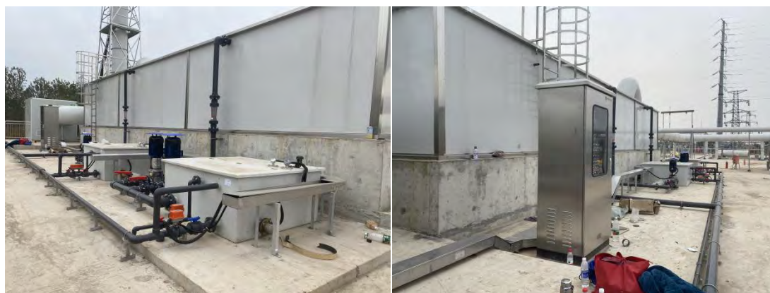
生物除臭装置
