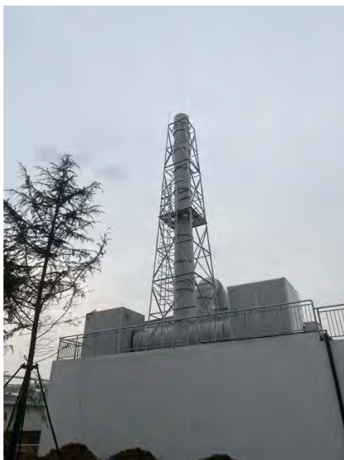
臭气排气筒（DA001）
