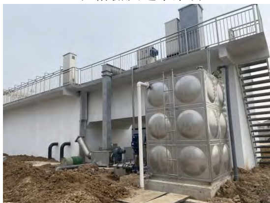
细格栅及曝气沉砂池
