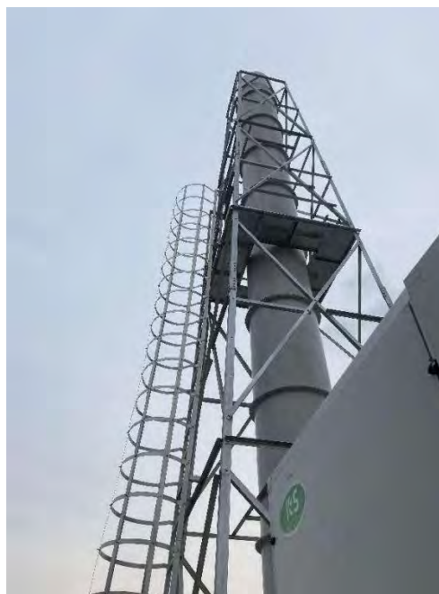
臭气排气筒（DA001）
