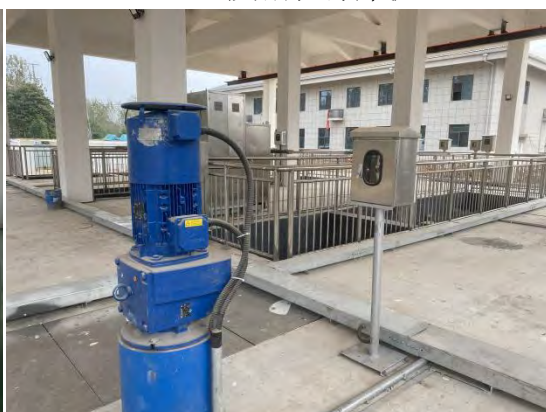
沉淀池及提升泵
